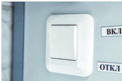
Выключатель в надстройке
